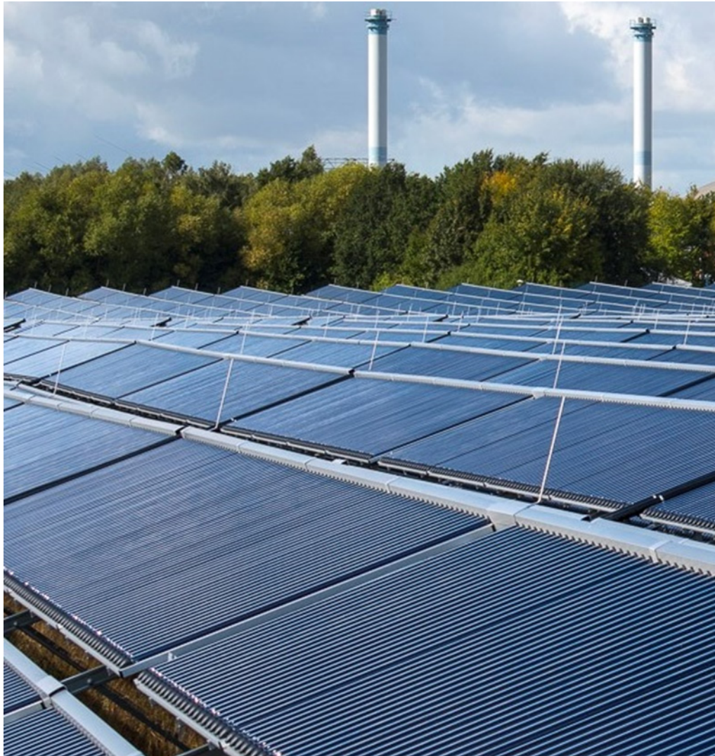
Stadt Greifswald, Vakuumröhrenkollektoren
